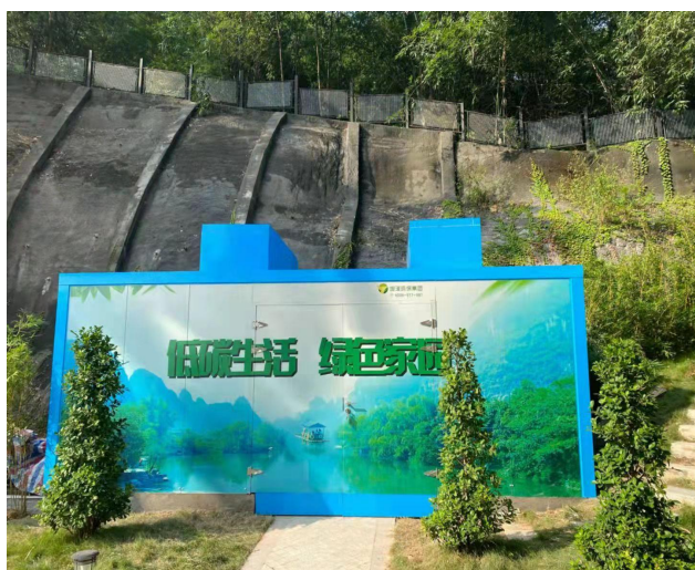
污水处理设施隔音降噪措施
