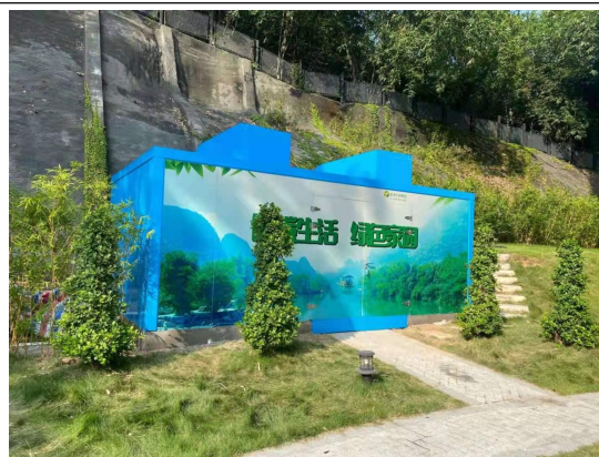
污水处理设备房
