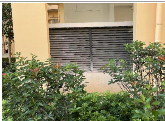
柴油发电机废气排放口
