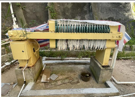
污泥压滤设备
