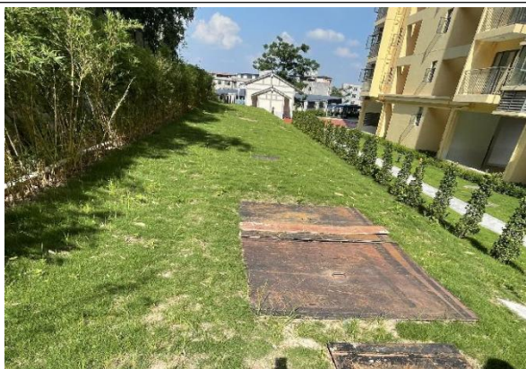
地埋式污水处理设施
