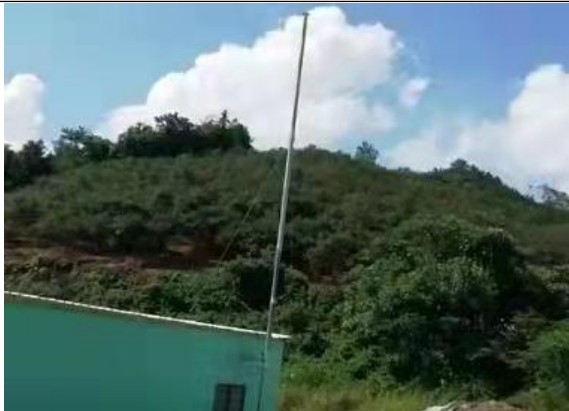
发电机废气排气筒
