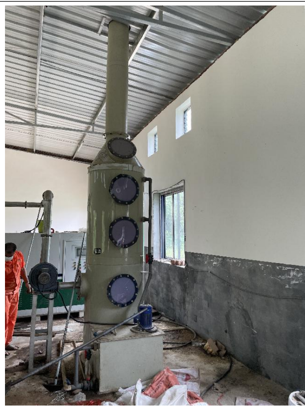
无害化设施尾气处理机
